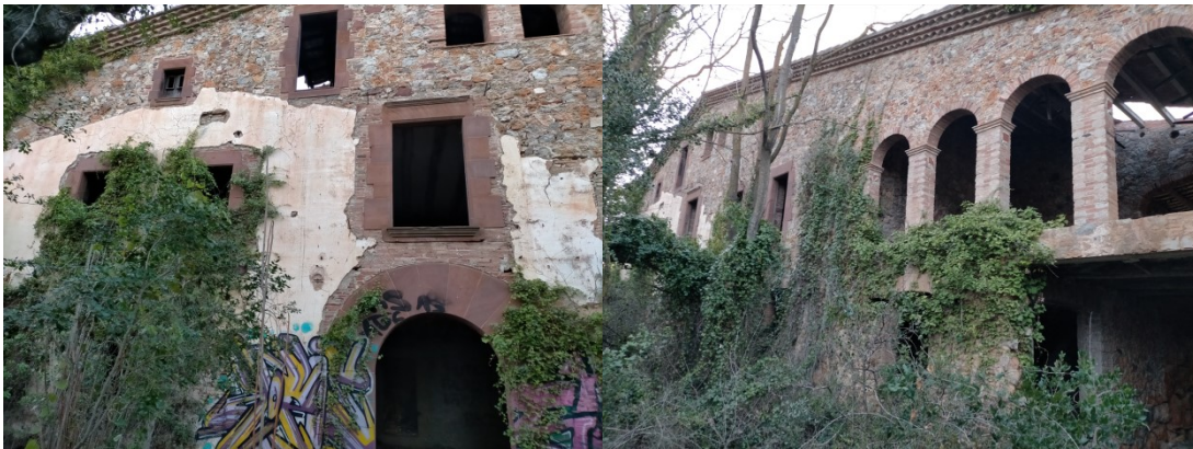
Façana principal de cal Jepet. Amb revestiment blanc la façana original a dues aigües, amb pedra vista l'ampliació dels anys 70. Els emmarcats de pedra també són dels 70.
